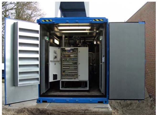
GELEVERD O.A.: ➤ 1 x 190 kWE MAN WKK IN CONTAINER MET ROOKGASSENKOELER; ➤ BIOGASKETEL 570 kW; ➤ OPTIMALISATIE BESTAANDE INSTALLATIE.
