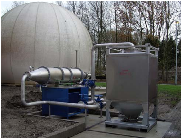
GELEVERD O.A.: BIOGAS CONDITIONERING: ➤ KOELINSTALLATIE; ➤ KOOLFILTER; ➤ BLOWER.
